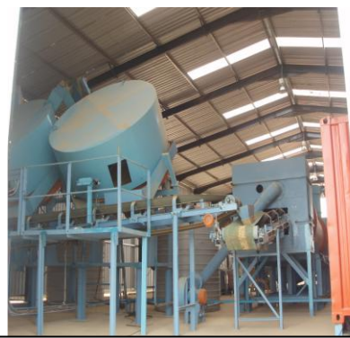
Vue partielle de l'usine de granulation
